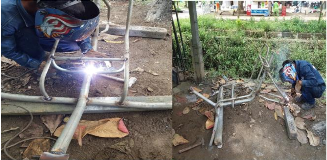
Figura 59. Unión por soldadura del habitáculo y el tren trasero al tubo central.
