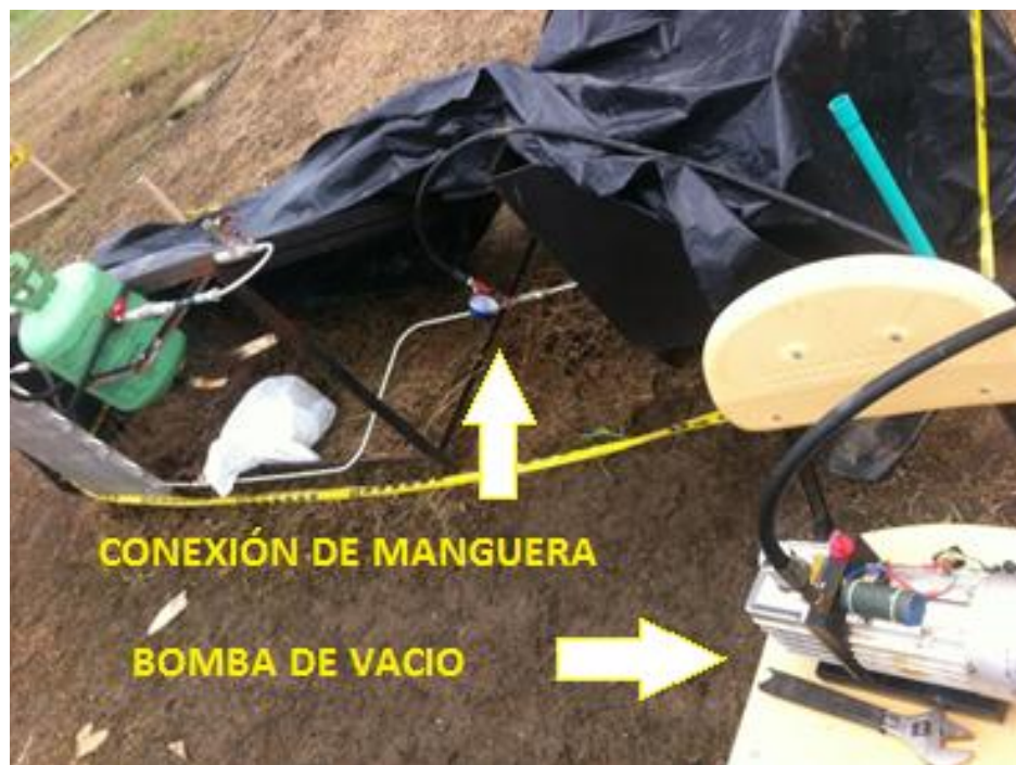
Anexo 12. Fotografía conexión de manguera y bomba de vacío al sistema.
