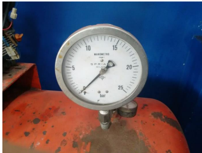
Figura 16. Manómetro. Fuente (Elaboración propia)
