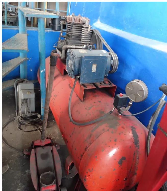
Figura 21. Compresor. Fuente (Registro fotográfico, 2019)
