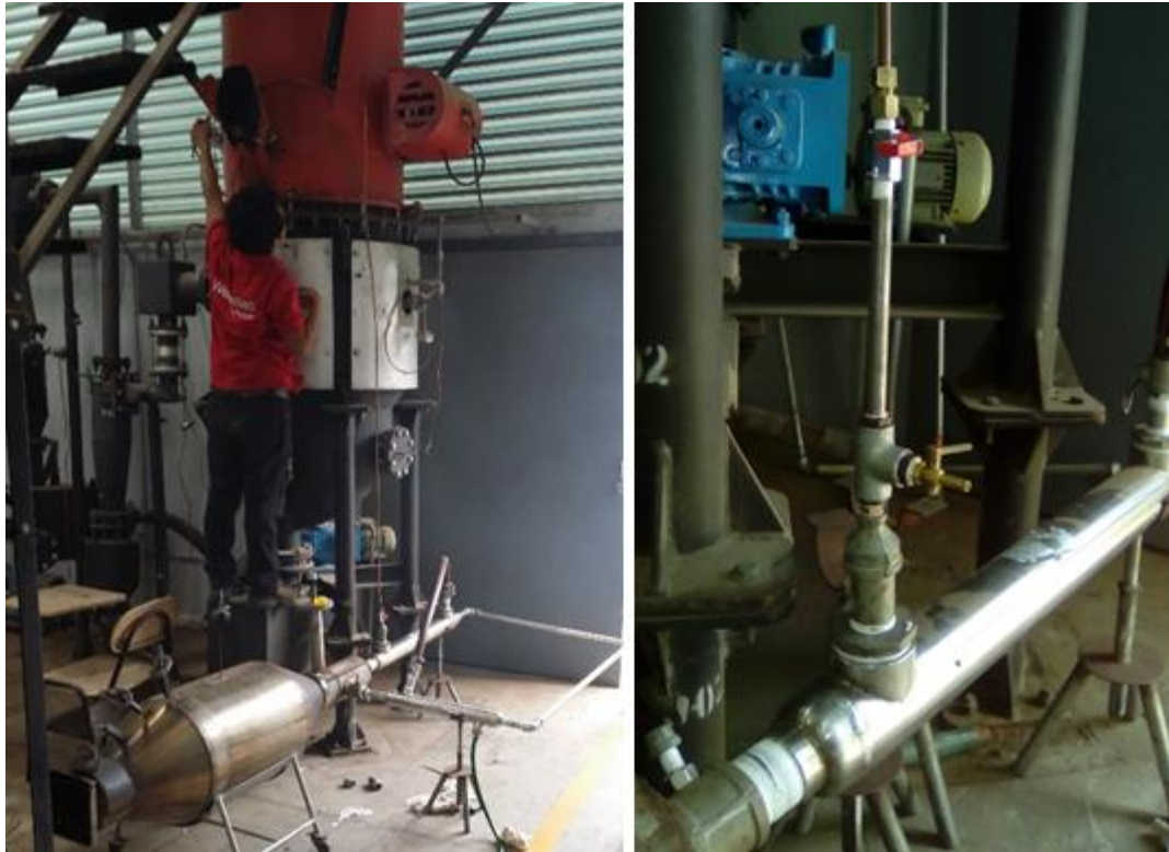
Figura 13. Conexión del banco de intercambiadores al gasificador.
