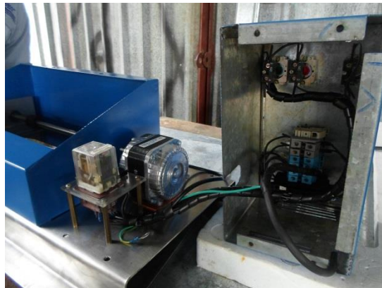
Figura 40. Sistema Eléctrico Fuente: Autores del proyecto.
