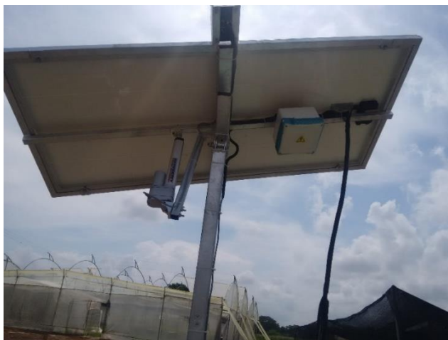
Figura 67. Disposición final del seguidor. Fuente: elaboración propia
