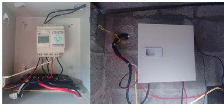
Figura 66. Conexión del controlador de carga y el PLC. Fuente: elaboración propia.
