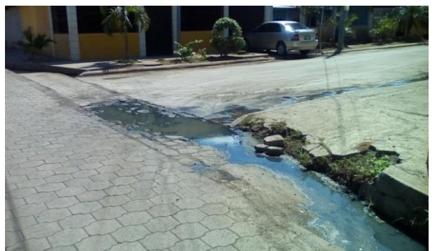
Imagen I.2 Aguas Vertidas adoquinado
