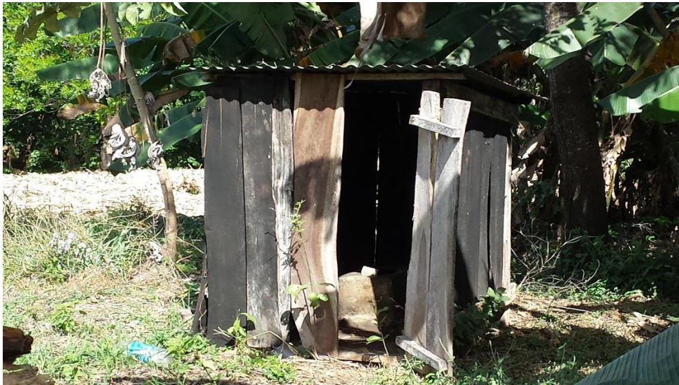
Foto 18. Servicio sanitario de los trabajadores del trapiche actualmente
