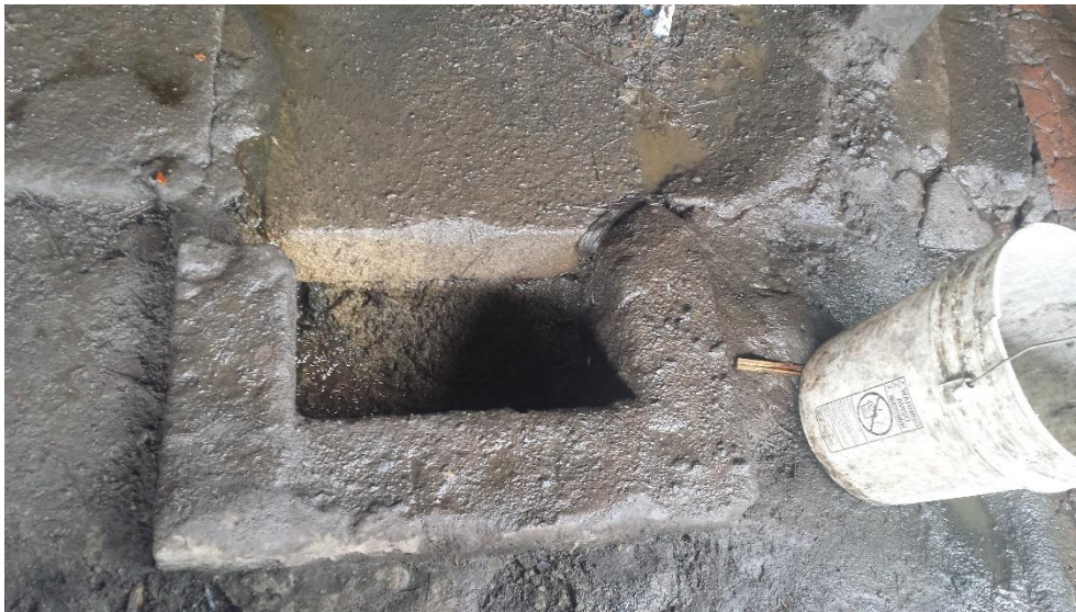
Foto 16. Caja de registro de las aguas residuales del proceso del trapiche
