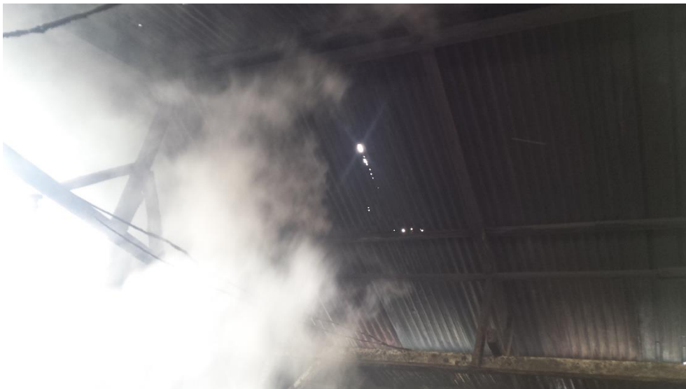
Foto 9. Techo actual en mal estado estado.
