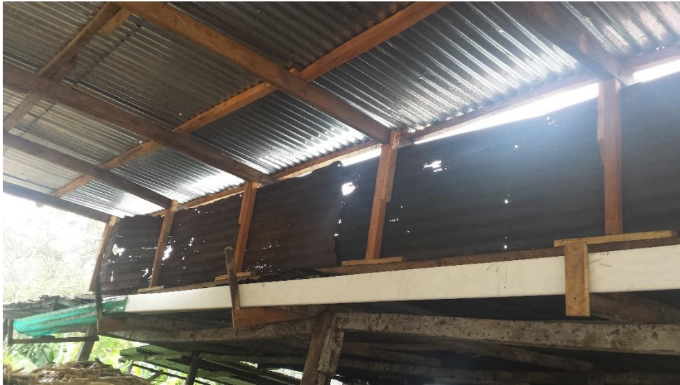
Foto 8. Techo actual en mal estado
