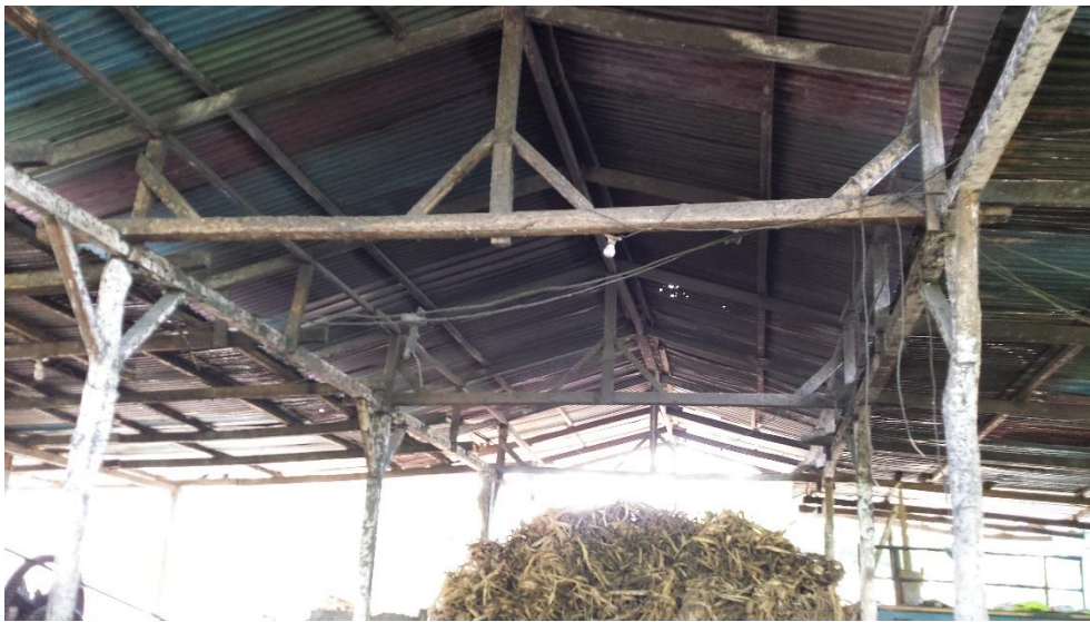
Foto 10. Existencia de cables eléctricos colgantes en el área de proceso
