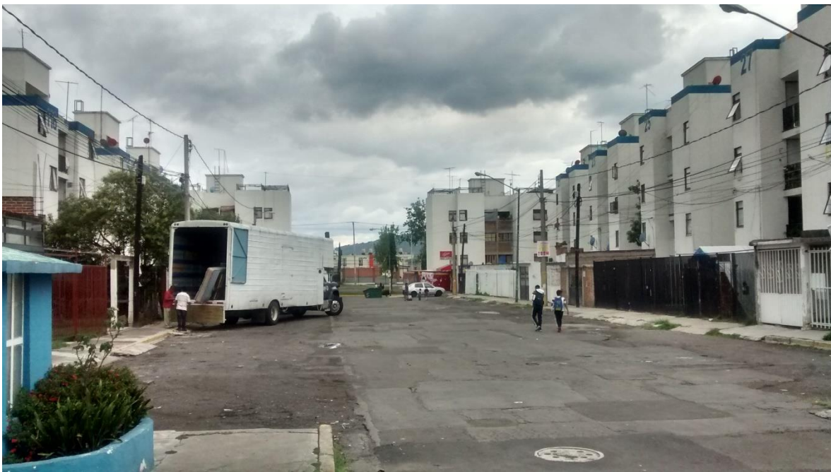
Fotografía 8 Pavimento de calles con severas intervenciones.
