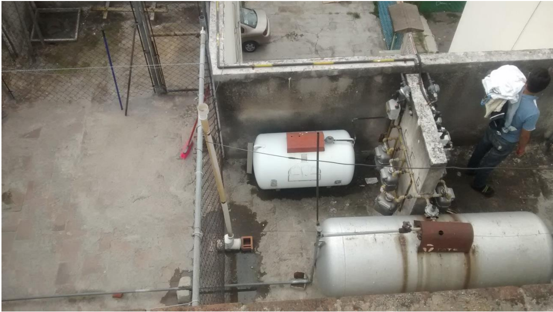
Fotografía Complementaria 36 Tanques estacionarios de gas.
