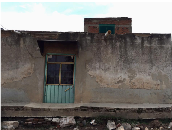
Figura 51. Vivienda con deterioros Autor: Arq. Carlos Urcino Pérez Montuy
