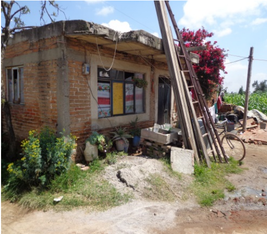
Figura 68. Deterioro evidente en la vivienda Autor: Anónimo Año: 2015
