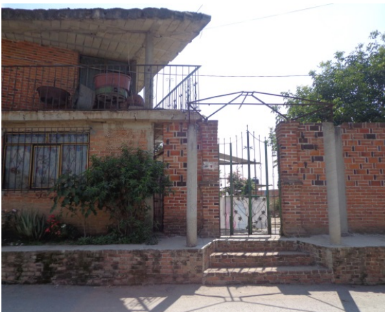
Figura 66. Deficiencia de calidad en colocación de losa Autor: Anónimo Año: 2015
