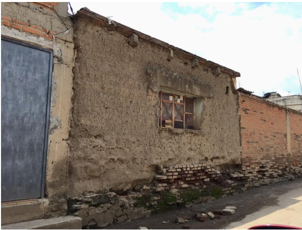
Figura 49. Viviendas típicas de San Diego Cuachayotla. Primera visita de campo Autor: Arq. Carlos Urcino Pérez Montuy
