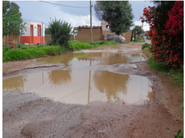
Figura 54. Calle Venaditos (sin pavimentar) Autor: Anónimo Año: 2015
