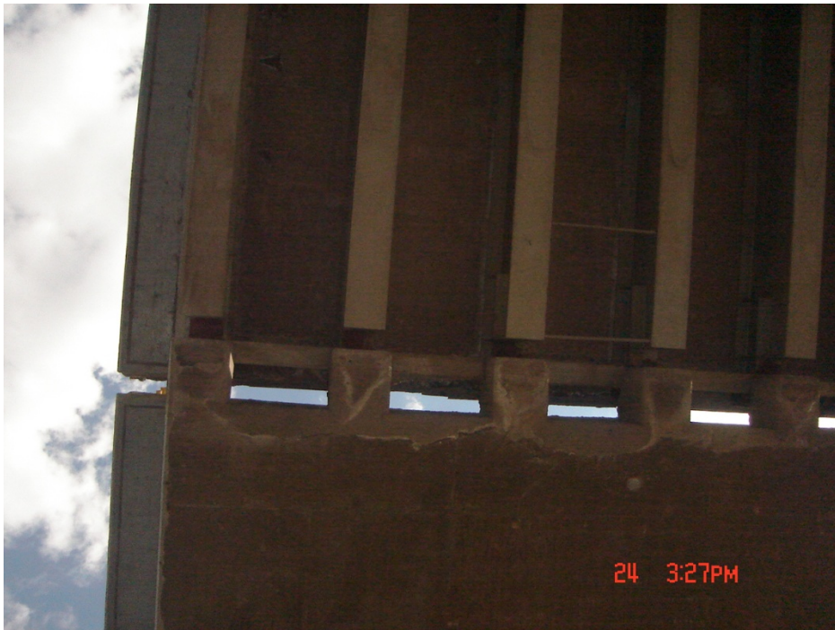
Figura No. 7. Vista inferior de junta en puente de acero
