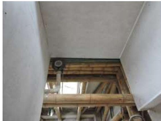
Figura 3.29 Instalaciones en planta alta
