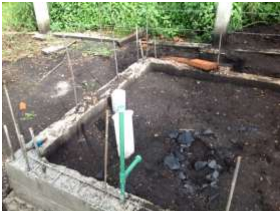
Figura 3.28 instalaciones en planta baja
