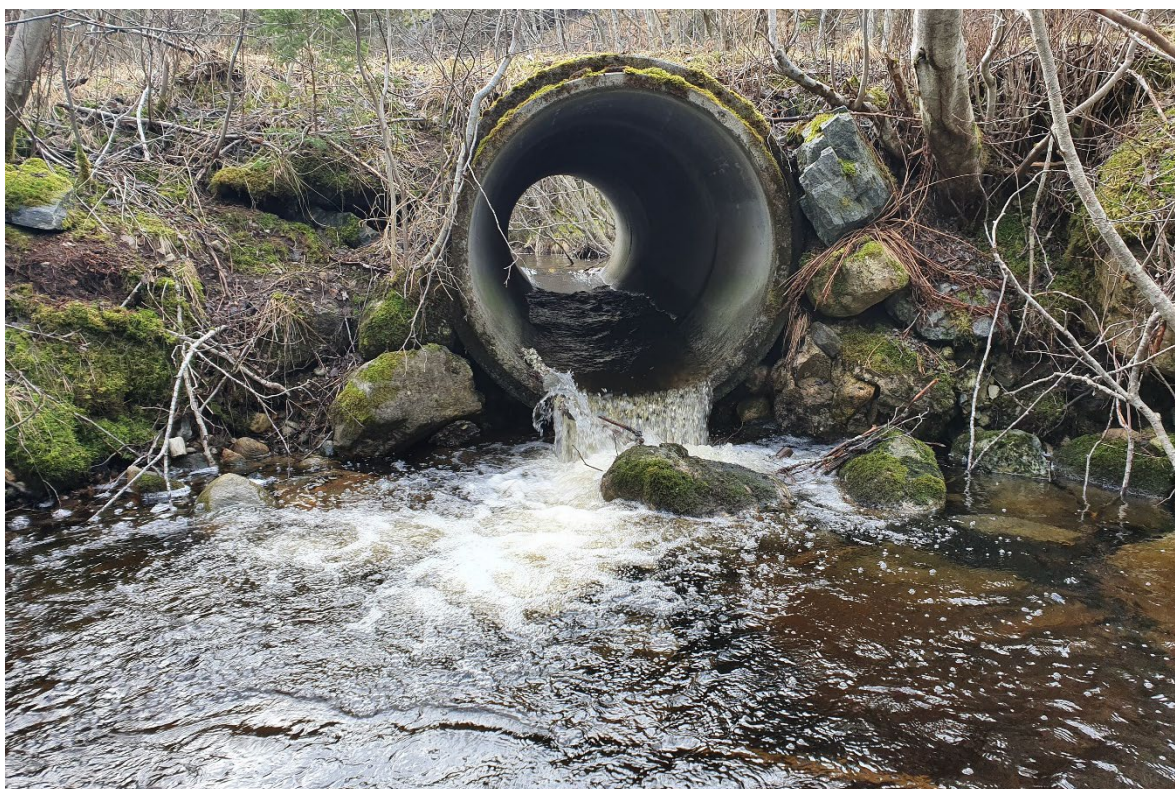
Bilde 4. Steiner som har rast ut fra forbygningen rundt kulverten under Søvassveien blokker delvis innhoppet. Foto: Torgeir B. Havn, NINA.
