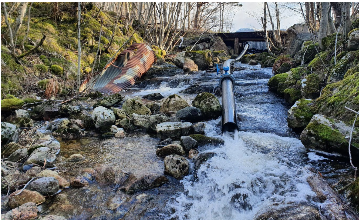
Bilde 9. Et rør er lagt fra Søvatnet og gjennom dammen for å sikre minstevannføringen på 30 l/s. Foto: Torgeir B. Havn, NINA.
