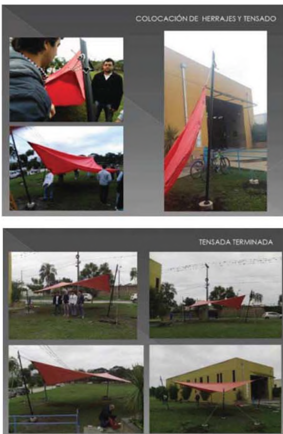
Figura 4y5: Colocación de herrajes y tensado de la membrana y terminación del "Feriador". Fuente: Proyecto de Investigación CIUNT B503 "Didáctica Proyectual".
