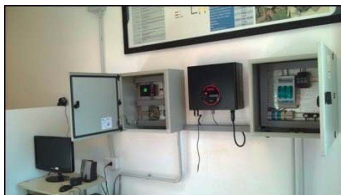
Figura 4: Tableros eléctricos del SFCR donde se observan la caja con protecciones de AC, inversor, caja con protecciones CC, datalogger y PC para almacenamiento de datos.
