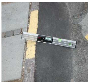
Rampe, som er for stejl
