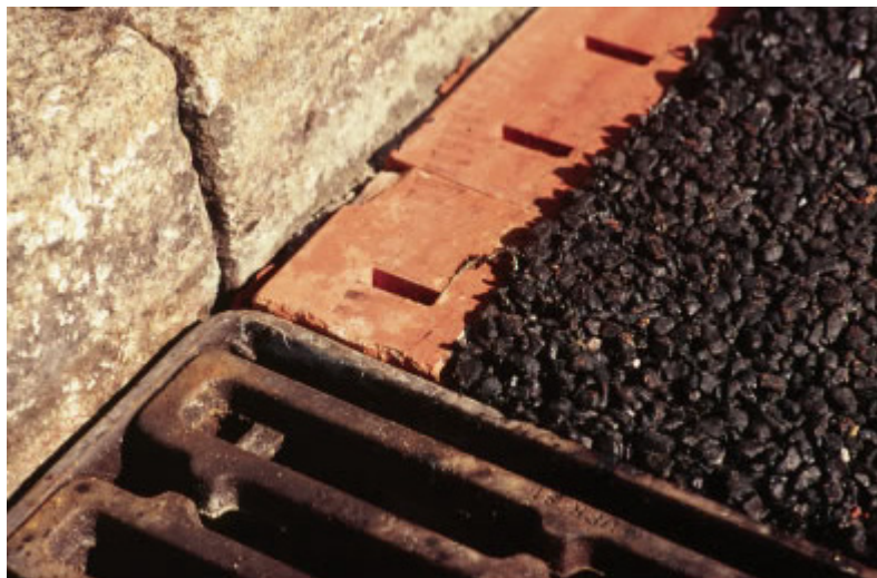
Figur 3. Regnvand, der falder på drænasfalten, trænger ned i belægningsstrukturen og løber mod vejsiden. Ved kantstenen er der etableret et afvandingssystem med nogle blokke, som har åbninger ud mod drænasfalten i hele dennes tykkelse, således at regnvandet løber ind i disse blokke og bliver ledt til afløbsbrøndene.
