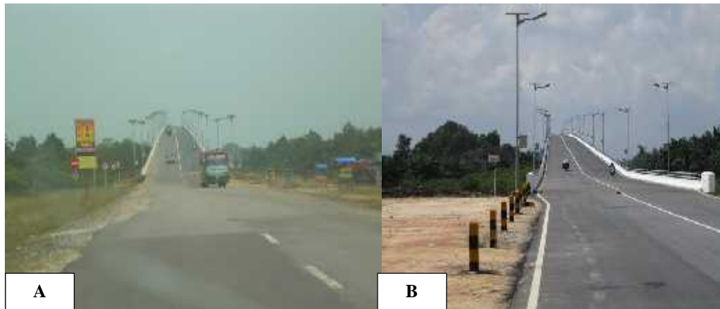
Gambar 5. A). Kondisi kenampakkan jalan di jembatan daerah tualang. B). Kondisi setelah diperbaiki tetap memperlihatkan adanya pergeseran.
