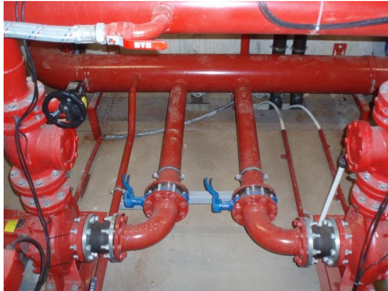
Figura 4.15 – Coletor de aspiração de água do reservatório.
