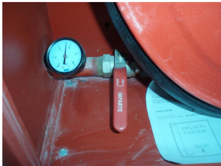
Figura 4.18 – Boca-de-incêndio tipo carretel com manómetro.
