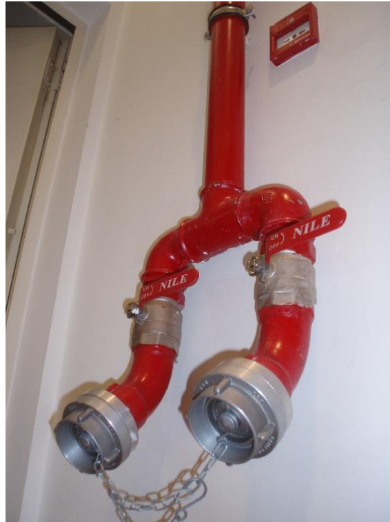
Figura 4.7 – Boca dupla de piso tipo storz.
