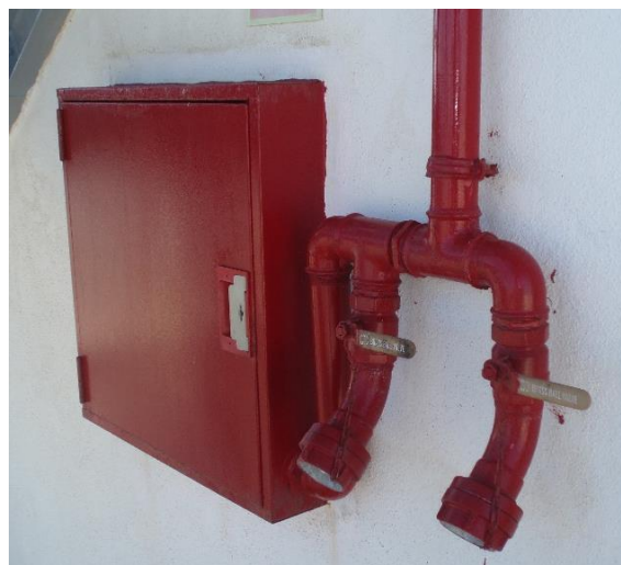
Figura 4.8 – Carretel de primeira intervenção e boca dupla tipo storz para segunda intervenção nos últimos pisos de serviço.
