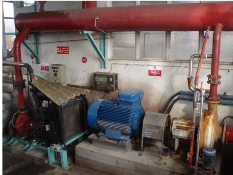
Figura 4.31 – Grupo de bombagem composto por uma bomba a gásóleo e outra elétrica, secundário.
