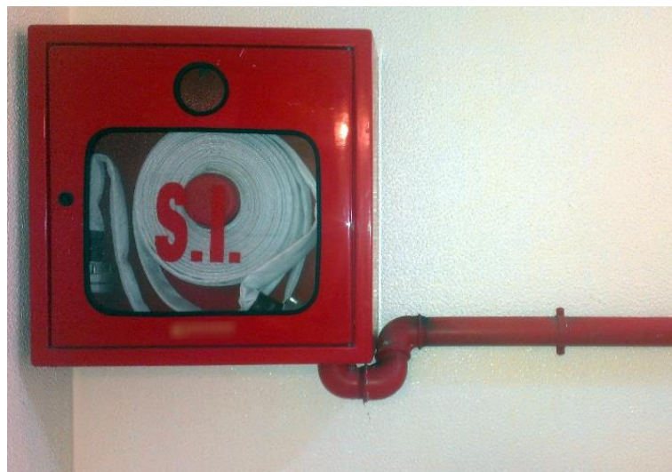
Figura 4.1 – Ligação incorreta de ramal de ligação a boca armada.
