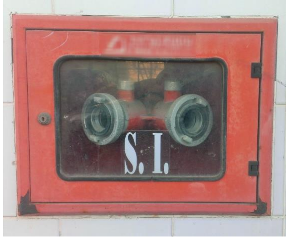
Figura 4.3 – Boca de alimentação primária na fachada do edifício habitacional.
