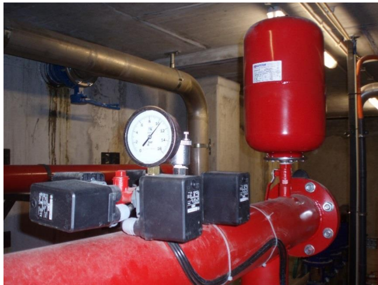
Figura 4.16 – Barómetro e acumulador hidropneumático.
