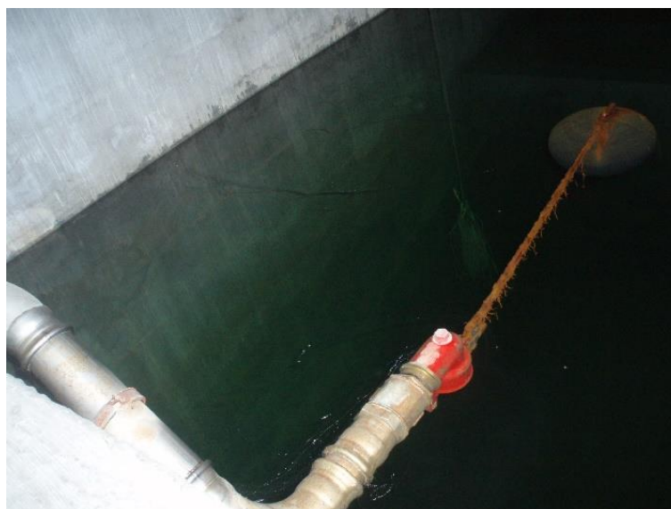
Figura 4.11 – Reservatório de água para combate a incêndios.
