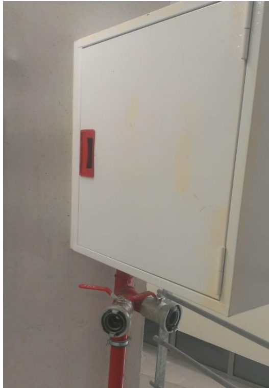
Figura 4.4 - Carretel com boca dupla (edifício escolar em Guimarães, 2014).
