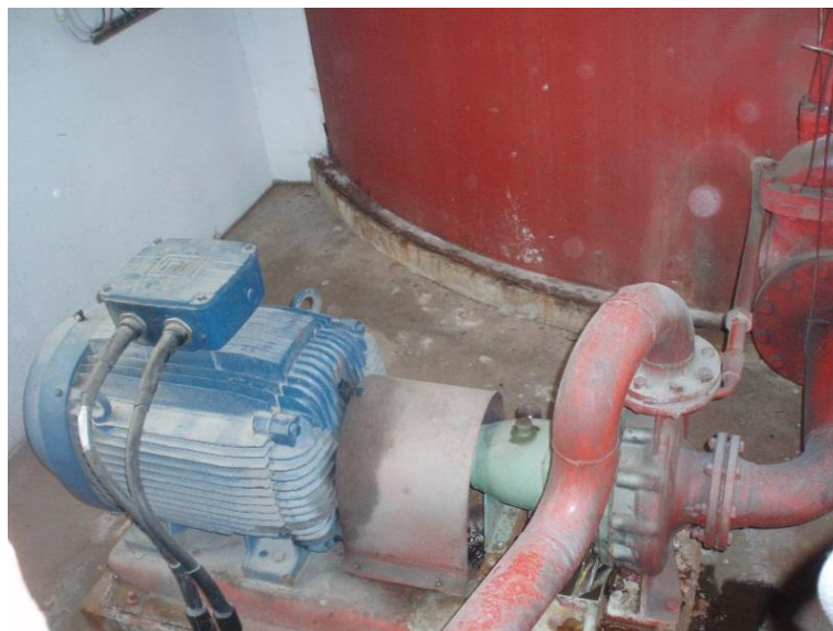
Figura 4.29 – Bomba elétrica do grupo de bombagem de combate a incêndios.
