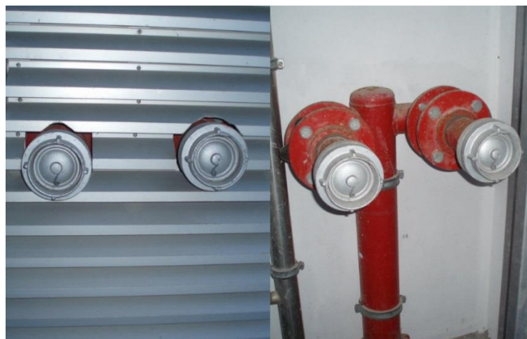
Figura 4.21 – Boca siamesa de alimentação alternativa do tipo storz com válvulas de retenção do tipo bolacha.
