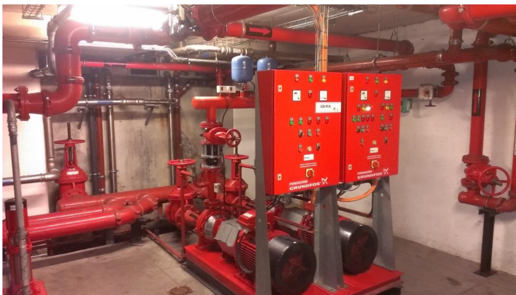
Figura 2.11 - Grupo de bombagem para redes húmidas (Hospital da Luz, Lisboa, 2014).
