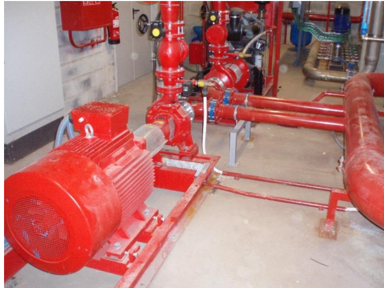
Figura 4.14 – Grupo de bombagem da rede de incêndios.
