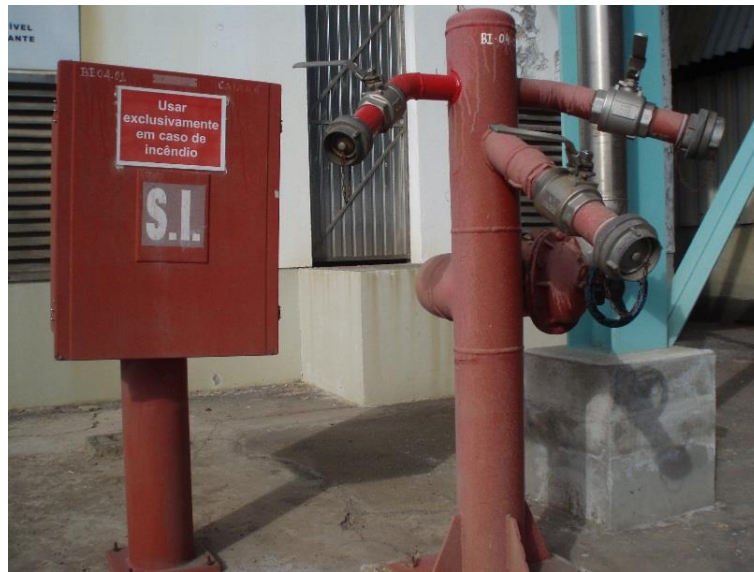
Figura 4.27 – Hidrante e armário com material de bombeiros, como mangueiras e agulhetas.
