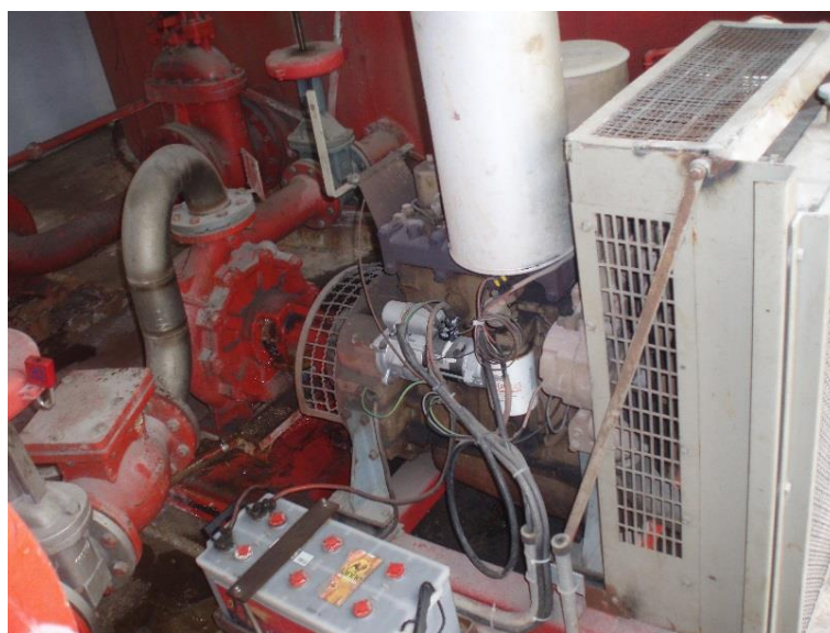
Figura 4.30 – Bomba a gasóleo para o grupo de bombagem de combate a incêndios.
