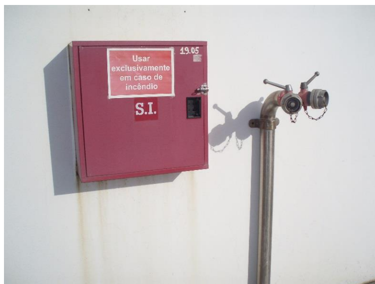
Figura 4.28 – Boca dupla de combate a incêndios e caixa com ferramentas para uso dos bombeiros.
