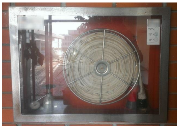
Figura 4.24 – Boca-de-incêndio tipo teatro adequada a rede húmida de segunda intervenção (pavilhão em Aveiro).
