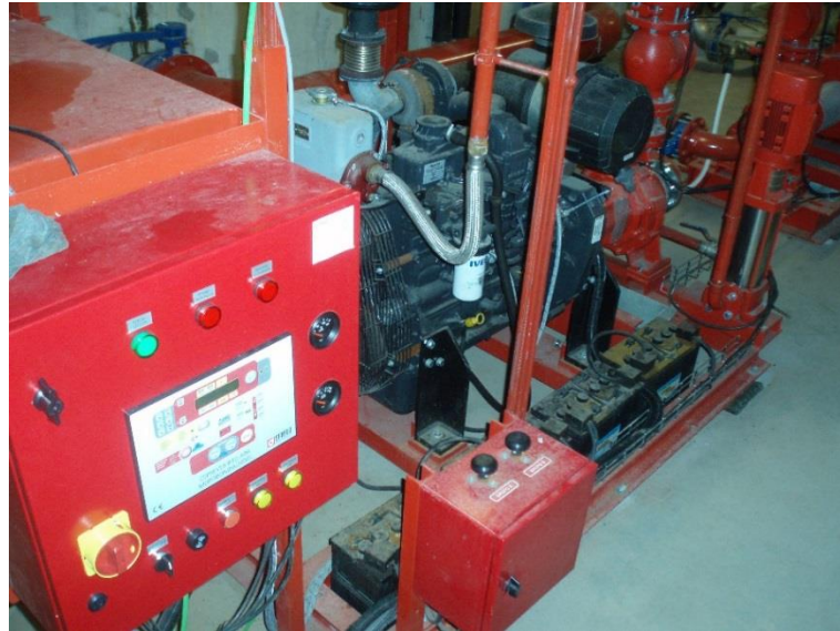
Figura 4.17 – Aparelho de motorização, motobomba e bomba “jockey”.
