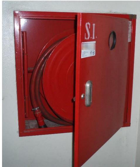
Figura 4.25 – Boca-de-incêndio tipo carretel, adequada a rede húmida de primeira intervenção.
