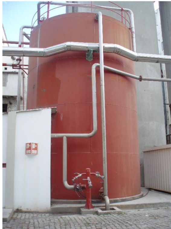
Figura 4.26 – Reservatório metálico privado para o combate a incêndios.
