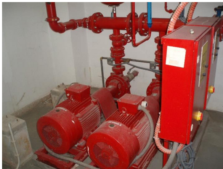
Figura 4.10 – Grupo de bombagem para a rede húmida do hotel.
