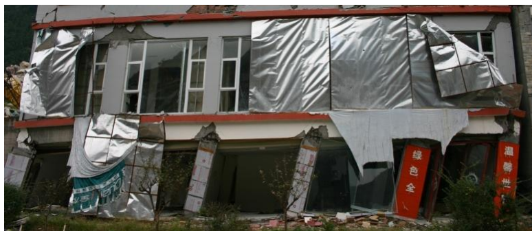
Figura 2 - Mecanismo “ soft-storey ” devido à presença de lojas no rés-do-chão (Costa, 2010).
