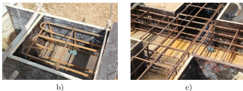
Figura 19 - Pormenores gerais da montagem e amarração da armadura: a) Vista geral do aspeto final das armaduras; b) Pormenor da amarração das armaduras longitudinais em gancho; c) Pormenorização das armaduras na zona de ligação do nó.
