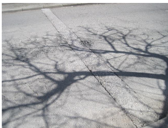
c) Aparecimento de fendas na ligação pavimento/reparação
