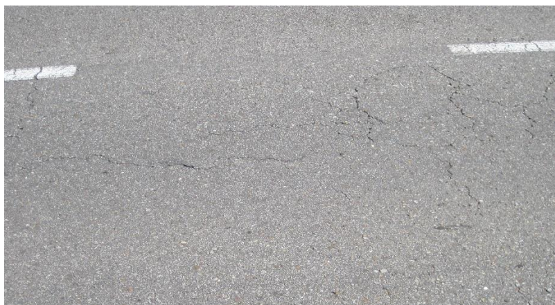
Figura 10: Fenda ramificada presente na Avenida da Universidade (fotografia de autor)
