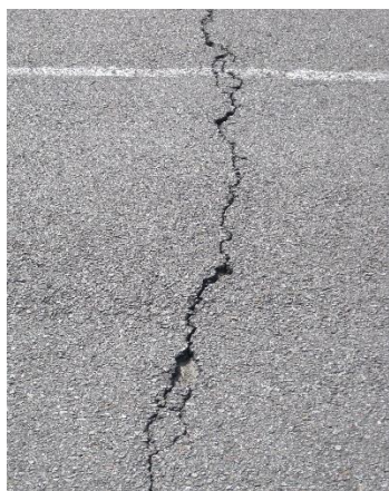
Figura 9: Fenda isolada presente na Avenida da Universidade (fotografia de autor)
