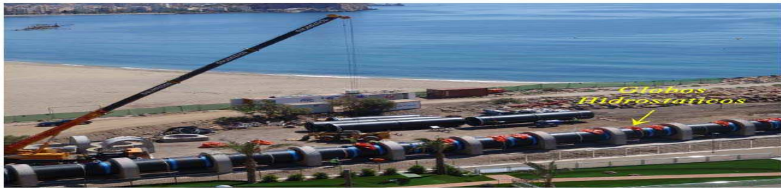
Fotografía 3. Montaje de globos hidrostáticos en el tramo de inmisario submarino que se encuentra constituido en la "lanzadera".
