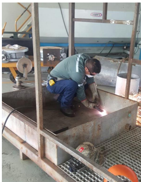
Figura 75. Modificación del tanque de enfriamiento con equipo de plasma.
