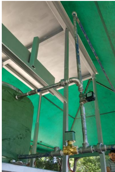
Figura 78. Conexión de tuberías entre el sistema de extracción de calor y el sistema de enchaquetamiento de la cuba.
