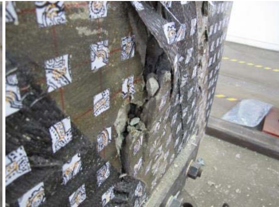
(d) Failure mode of U5-60-0-5
