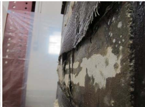
(d) Failure mode of U5-0-0-5
