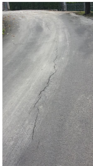
Fig. 46 – Unica vera crepa, posta a centro carreggiata, che potrebbe essere riconducibile a fenomeni di instabilità di versante.
