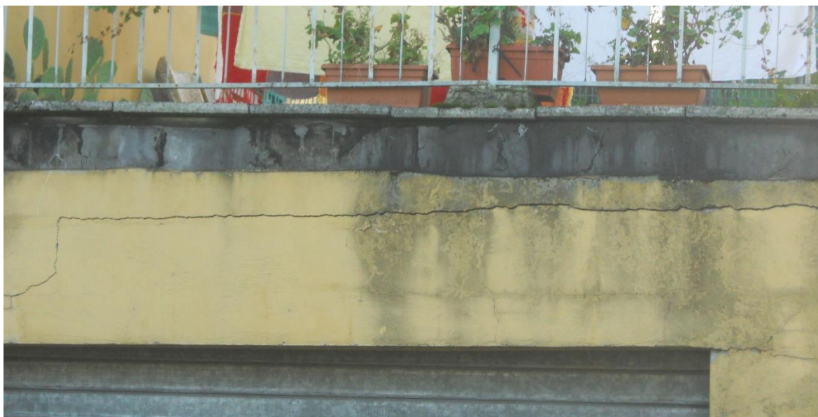
Fig. 45 – Una delle crepe che caratterizza la casa posta vicino alla stazione ferroviaria di Silla.
