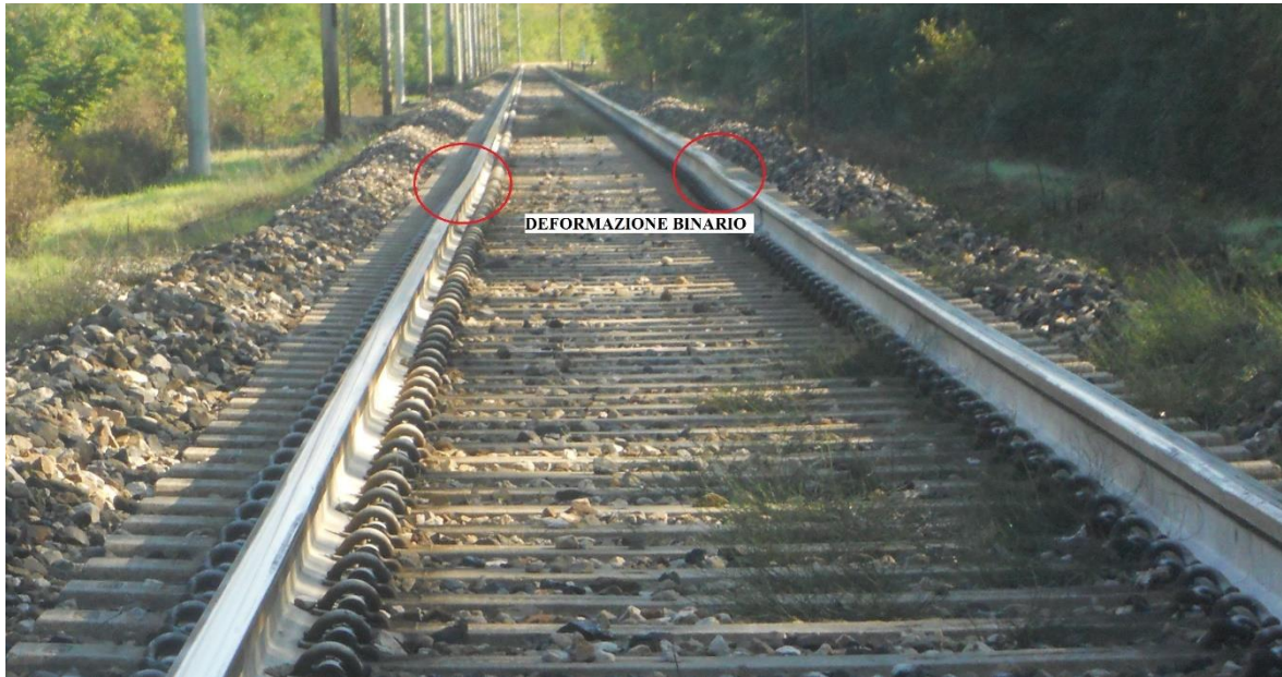
Fig. 1 – Deformazione del binario ferroviario nel punto più ad EST del rilevato.
