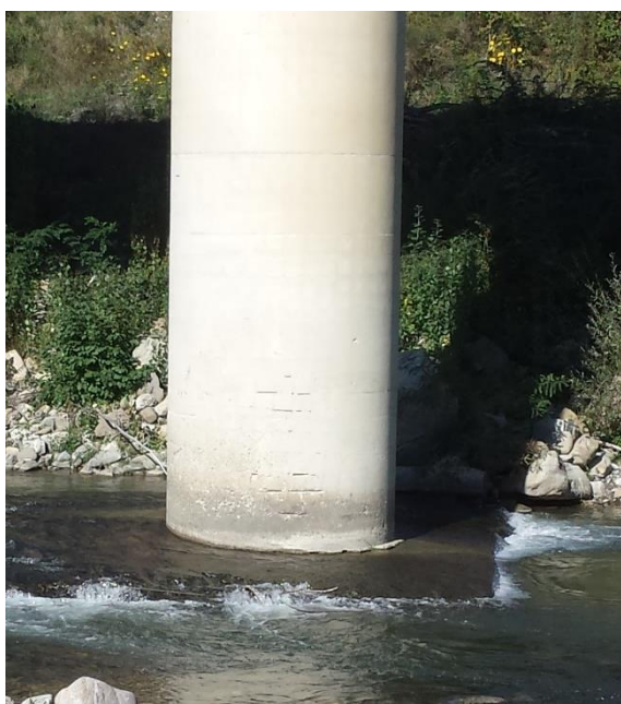
Fig. 47 – I piloni osservati all'interno dell'alveo del fiume Reno sembrano essere fortemente in erosione.
