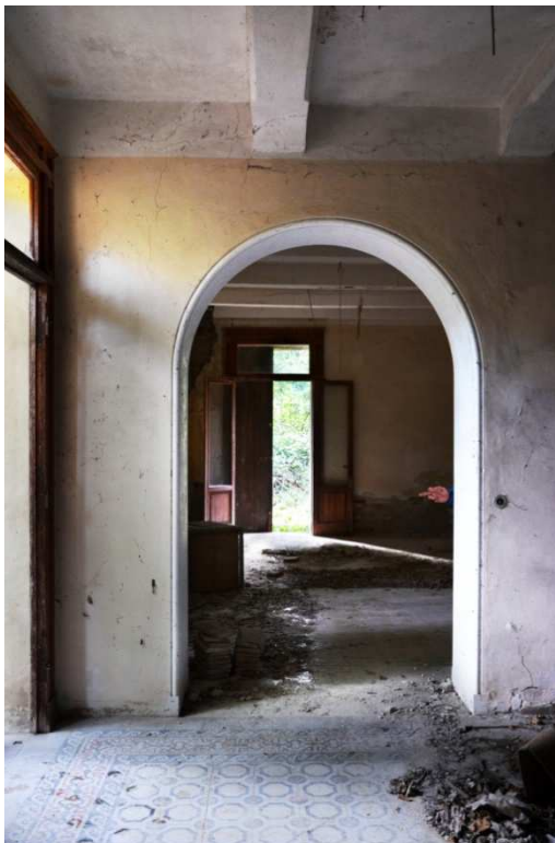
Fig. 63 Pavimentazione in graniglia con notevoli depositi ed incrostazioni.
