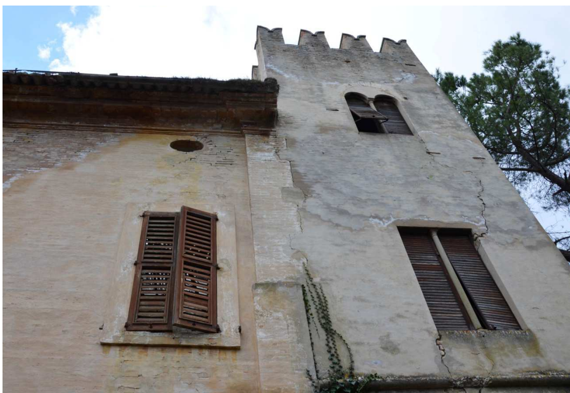
Fig. 53 Ammorsatura tra edificio principale e torre. Risulta evidente come le due costruzioni siano state realizzate in momenti diversi.
