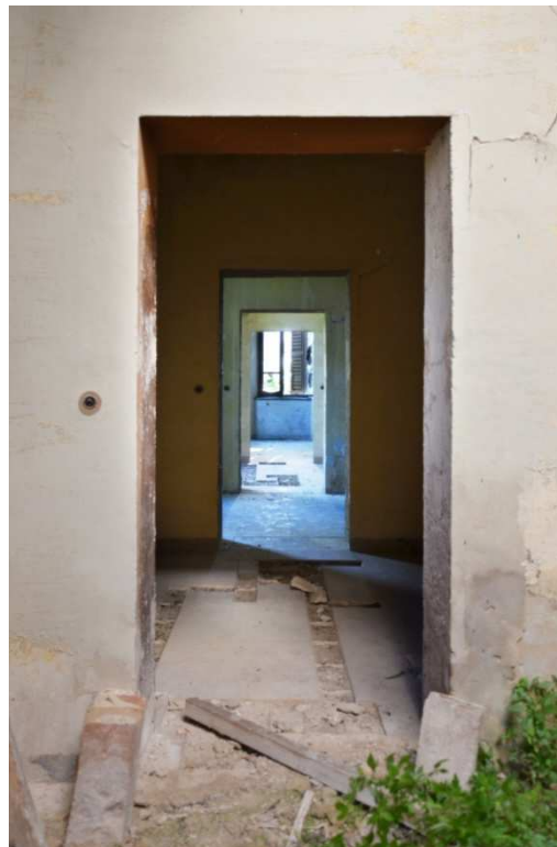
Fig. 62 Mezzanelle in cotto mancanti nella pavimentazione al piano primo.
