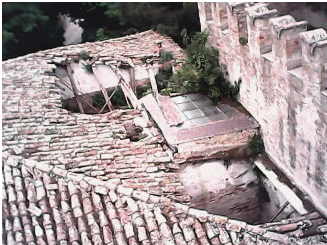
Fig. 55 Crollo della copertura in corrispondenza della camera rosa (in primo piano a destra) e del salone.
