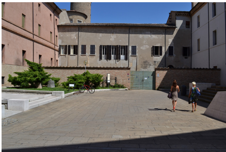
Fig. 1. Vista dell'affaccio degli uffici della Soprintendenza su piazzetta dell'Esarcato. Si noti come questa sia la facciata peggio conservata, anche perché non è stata interessata da restauri negli anni recenti, come invece è accaduto per le altre. Si noti la falda, posta a quota più bassa delle altre.
