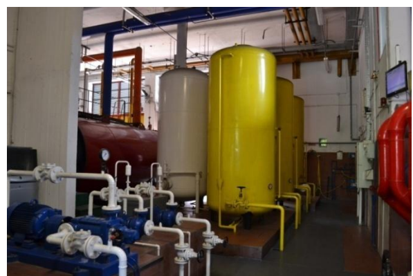
Figura 3.5: Serbatoio di reintegro (bianco) e vasi di espansione (gialli)
