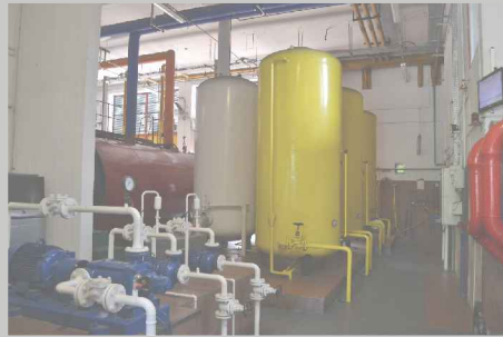
Serbatoio di reintegro (bianco) e vasi di espansione (gialli)
