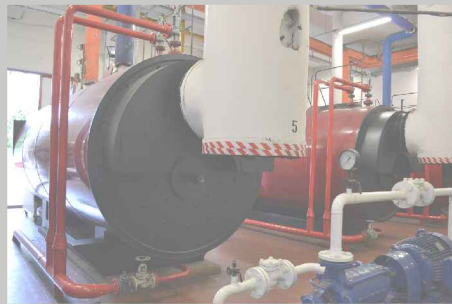
5 caldaie in acciaio con una potenza nominale utile di 2907 KW l'una
