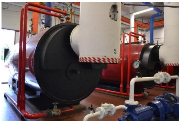
Figura 3.4: una delle 5 caldaie in acciaio con una potenza nominale utile di 2907 KW l'una
