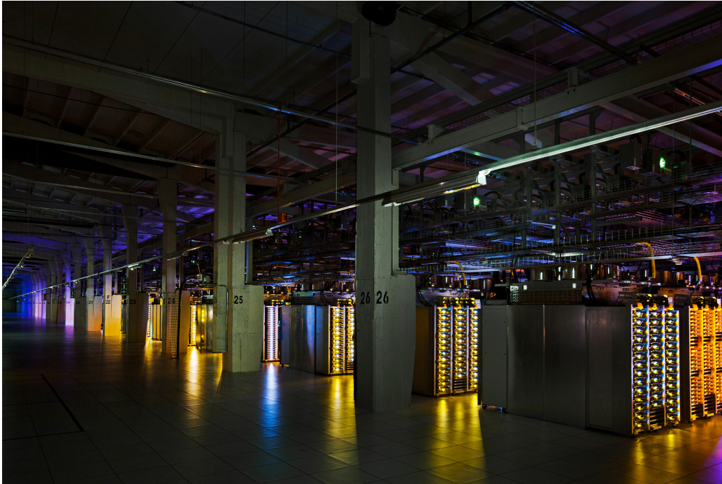
Figura 1.1: Datacenter di Google
