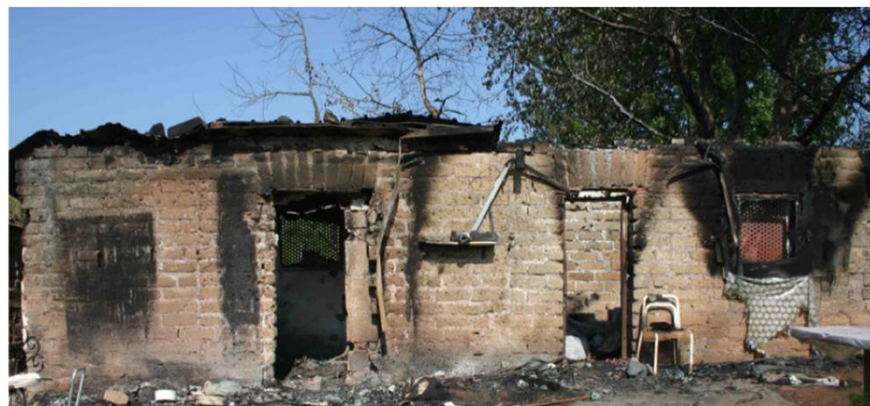
Effetti da fumo sulla facciata di un edificio incendiato
