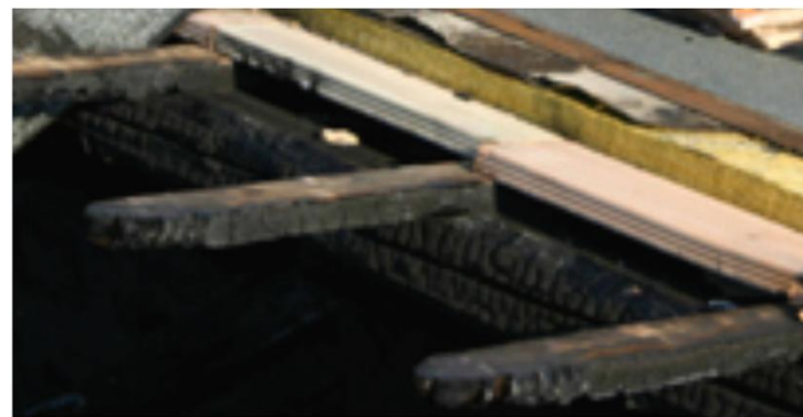
Danni su struttura di copertura in legno
