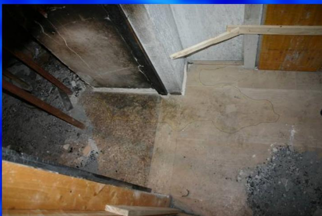
Benzina versata sulla porta di ingresso dell'appartamento
