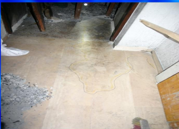
Segno lasciato dall'incendio che segue la pendenza del pavimento
