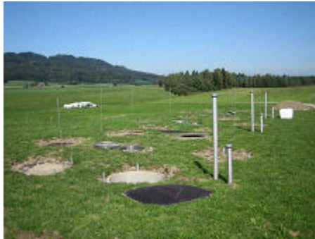
Installation von 18 Lysimetern im Fendt Gebiet innerhalb des Einzugsgebietes der "Ammer".
