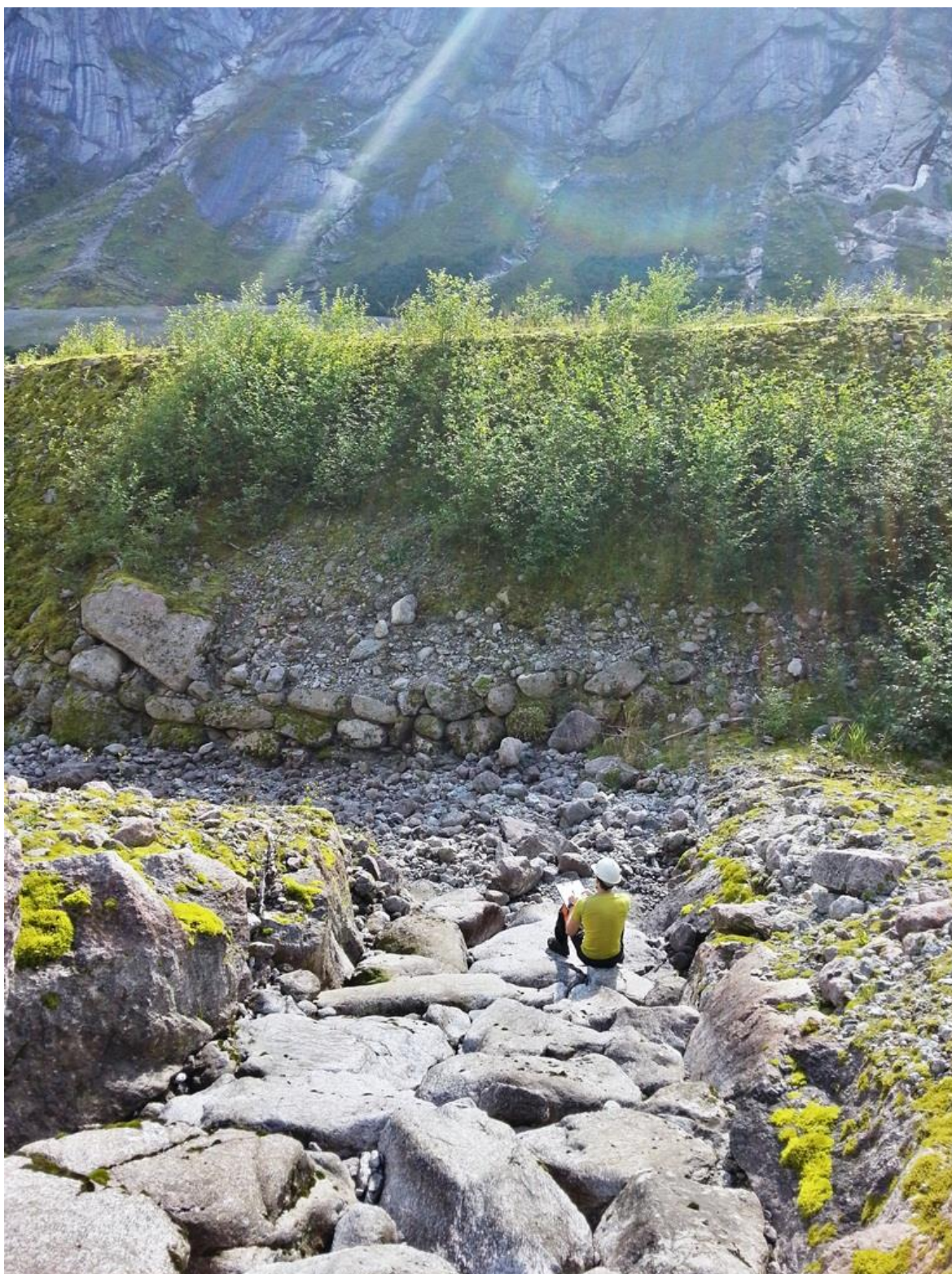
Figur 63: Allhauganevollen 1 i Kjøsnesfjorden har for lav tørrmur etter at magasinet er blitt fylt opp. Skred treffer vollen over tørrmuren og eroderer løsmassene i støtsiden. Utbedringstiltak er å tømme magasinet oftere, senke magasinet eller forhøye tørrmuren (foto: Feltarbeid 2013).
