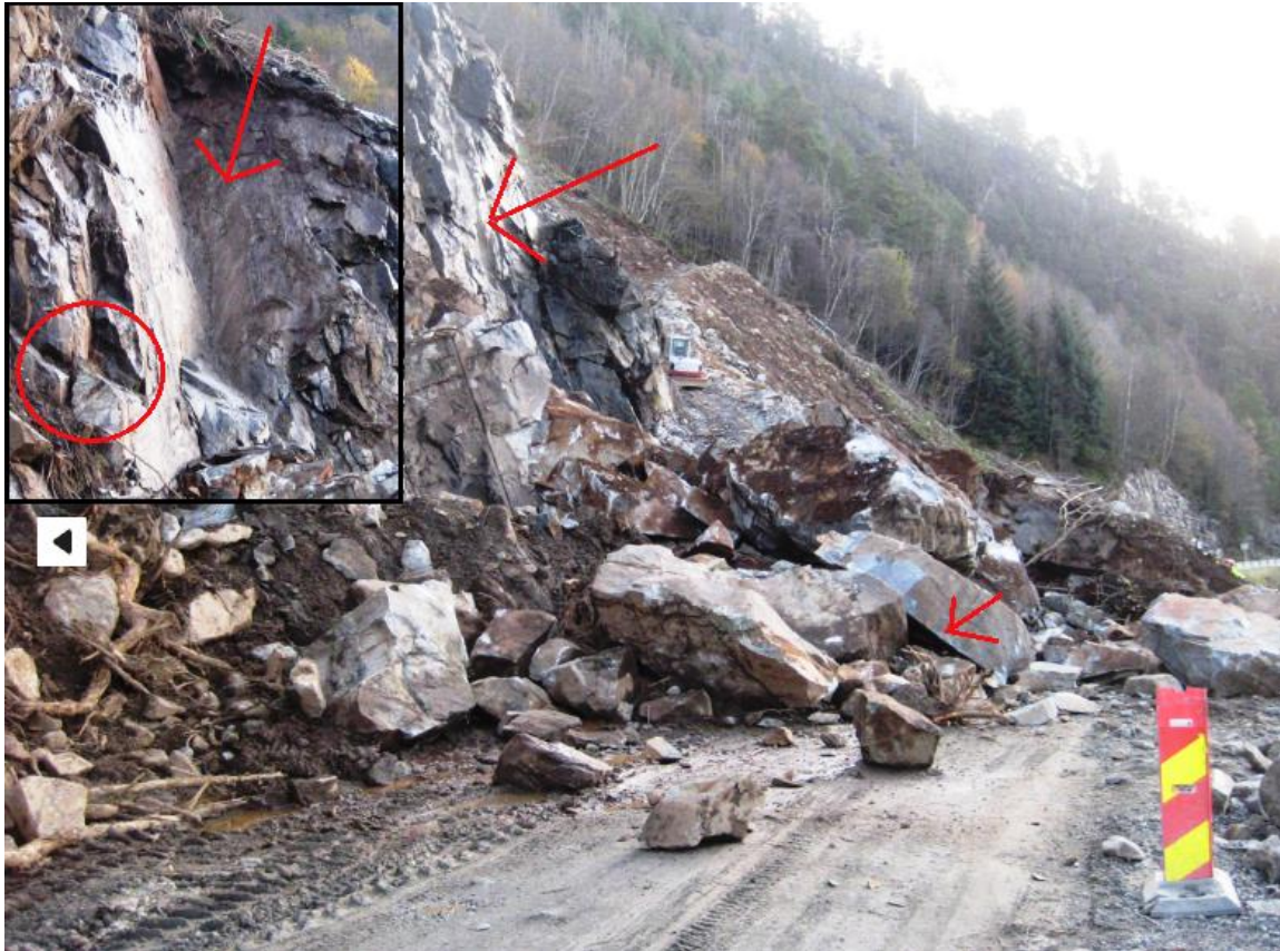
Figur 6: Fotoet viser oss 3 ulike sprekkeseett som favoriserer utglidning. Pilene viser to ulike sprekkeseett, og ringen ett. Modifisert foto fra (Statens vegvesen, 2014).
