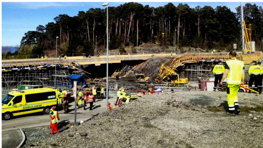
To personer mistet livet da en bru under oppføring kollapset i Trondheim onsdag. FOTO: Tor Aage Hansen
