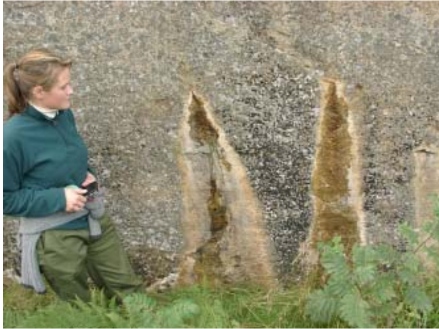
Figur 9.9. Kanalisering av vannstrømning. På grunn av at bruddet har varierende apertur, er det bare en liten del av bruddet som leder vann. Bildet er fra lokalitet Skålavika og er fotografert mot SV. Person som skala.
