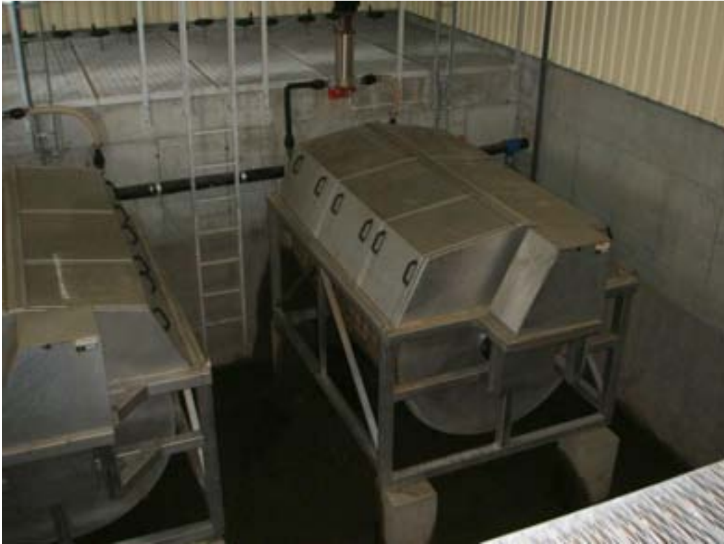
Figur 3. Avløpsfilter som sekundærsikring
