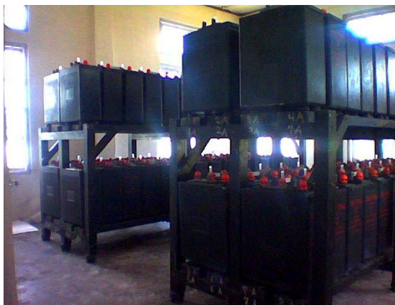
Batteribank til solcellekraftverk (Shri Shakti 2004)
