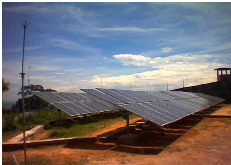
Et lite solcellekraftverk på 25 kW installert kapasitet, på et rehabiliteringssenter for rusmisbrukere (Shri Shakti 2004)
