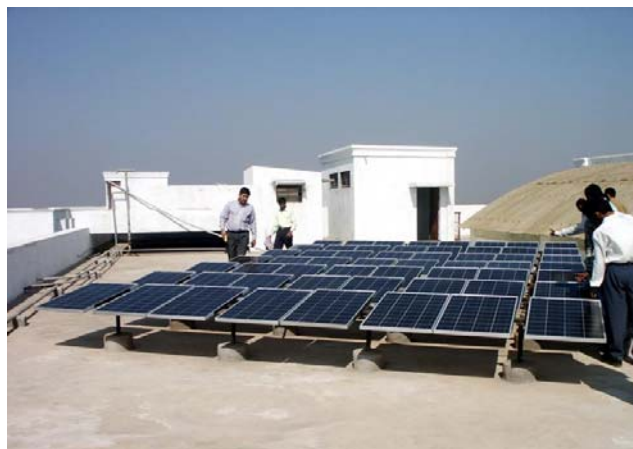
Solcelleanlegg på 4,5 kW installert kapasitet på et skoletak i Hyderabad (Shri Shakti 2004)
