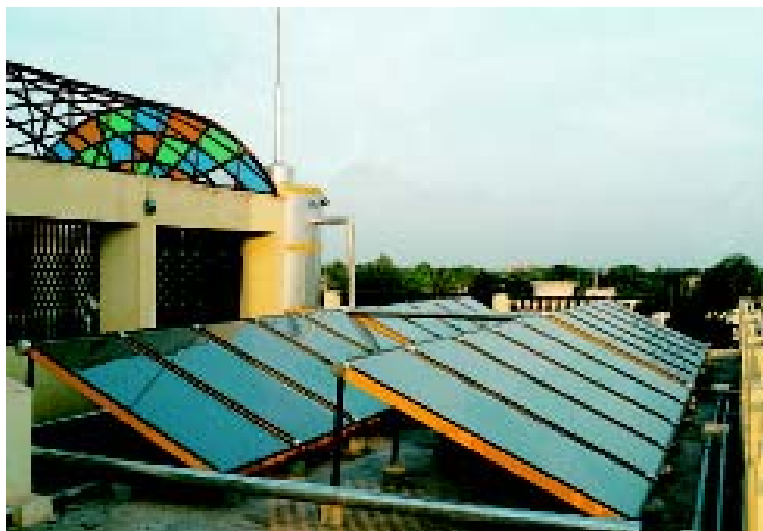
Solfangeranlegg for produksjon av varmt vann på et lærerutdanningssenter i Karnataka
