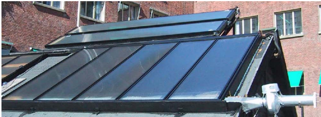
Figur 3.6: Solfangeranlegget består av 5 paneler.
