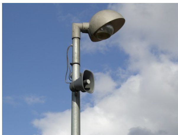
Figur 5.7 Høytaleranlegget på Blindern undergrunnsstasjon.
