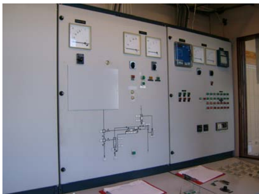
Bilde 4.4: Kontrollpanelet for buffermagasinene, bilde tatt på ResQ
