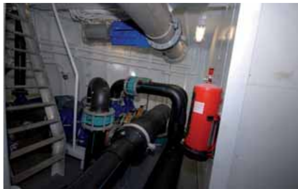
Figur 7. Sjøvannspumper med ND 250 samlestock.
