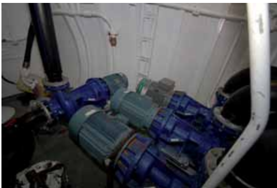
Figur 6. Sjøvannspumper for levendefangst. I bakgrunn frekvensregulert pumpe for RSW- og/eller sjøvann.
