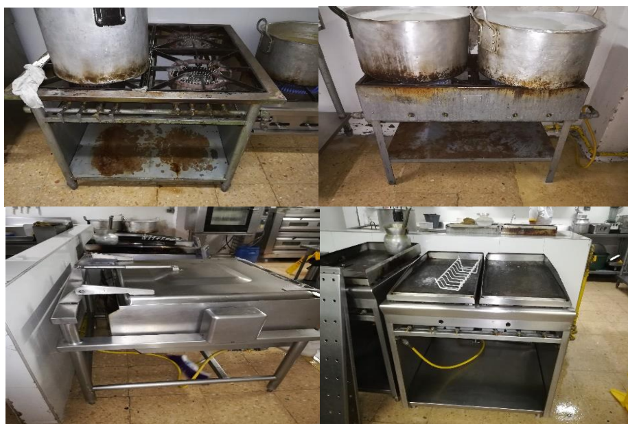
Ilustración 10: Condiciones de equipos
