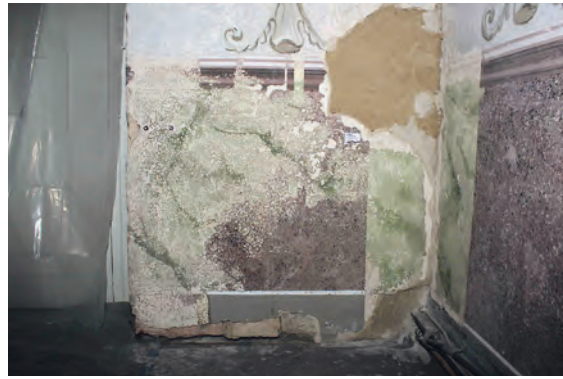
Abb. 4 Die stark versehrte Oberfläche links zeigt das Ergebnis der mechanischen Freilegungsmethode mit Skalpell und Nusschalengranulat. Im Wandanschlussbereich Probeflächen der Laserreinigung; freigelegter Zustand zeigt Abnutzungsspuren sowie Verluste der original Sockelmalerei infolge vorangegangener Renovierungsmaßnahmen.
