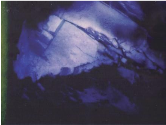
Figura N° 2. Roca a punto de colapsar en el techo de la rampa 42-3159. Nótense los planos de clivaje mucho más abiertos.
