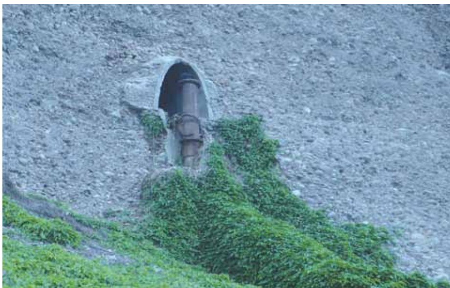
Figura N.º 3. Playa Los Delfines. Tubos de desagüe doméstico que descargan en el mar en forma oculta
