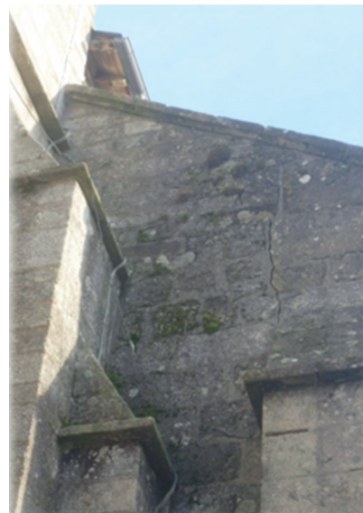
Fig. 3. Iglesia de Saint Antoine (Egletons, sudoeste de Francia) inspección realizada por HeritageCare el 27-02-2019: grieta asociada al asentamiento de la cimentación.
