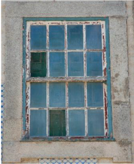
Fig. 7. Station télégraphique et routière de Cantareira (Porto, Portugal), inspection effectuée par HeritageCare le 20/02/2018: détail du cadre de la fenêtre.
