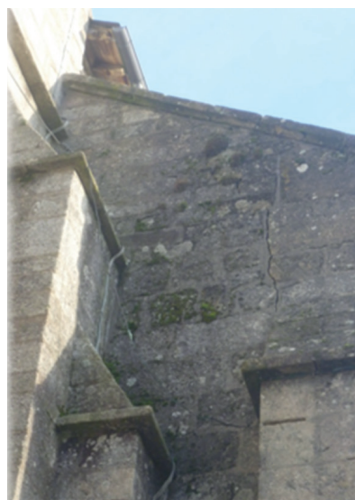
Fig. 3. Église de Saint Antoine (Egletons, sud-ouest de France) inspection effectuée par HeritageCare le 27-02-2019: fissure associée au tassement de la fondation.
