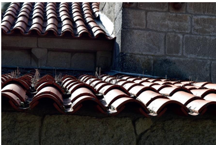
Fig. 4. Iglesia de São Tiago Adeganha (Torre de Mancorvo, Portugal), inspección realizada por HeritageCare el 22/10/2018: cubierta (tejado) de la sacristía.
