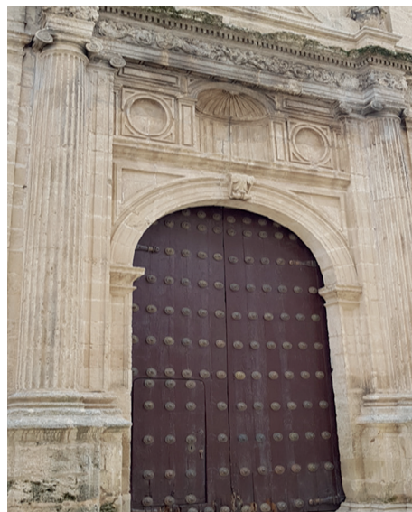
Fig. 8. Capela do Hospital de las Cinco Llagas, atual sede do Parlamento da Andaluzia (Sevilha, Espanha), inspeção efetuada por HeritageCare em 23-10-2018: detalhe da porta.
