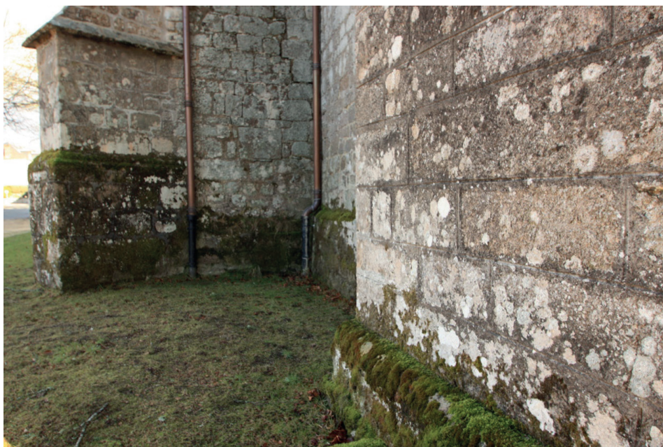
Fig. 5. Iglesia de Sainte Croix (Rosiers-d'Égletons, sudoeste de Francia), inspección realizada por HeritageCare el 26/02/2019.
