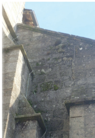
Fig. 3. Igreja de Saint Antoine (Egletons, sudoeste da França) inspeção efetuada por HeritageCare em 27-02-2019; fenda associada ao assentamento da fundação.
