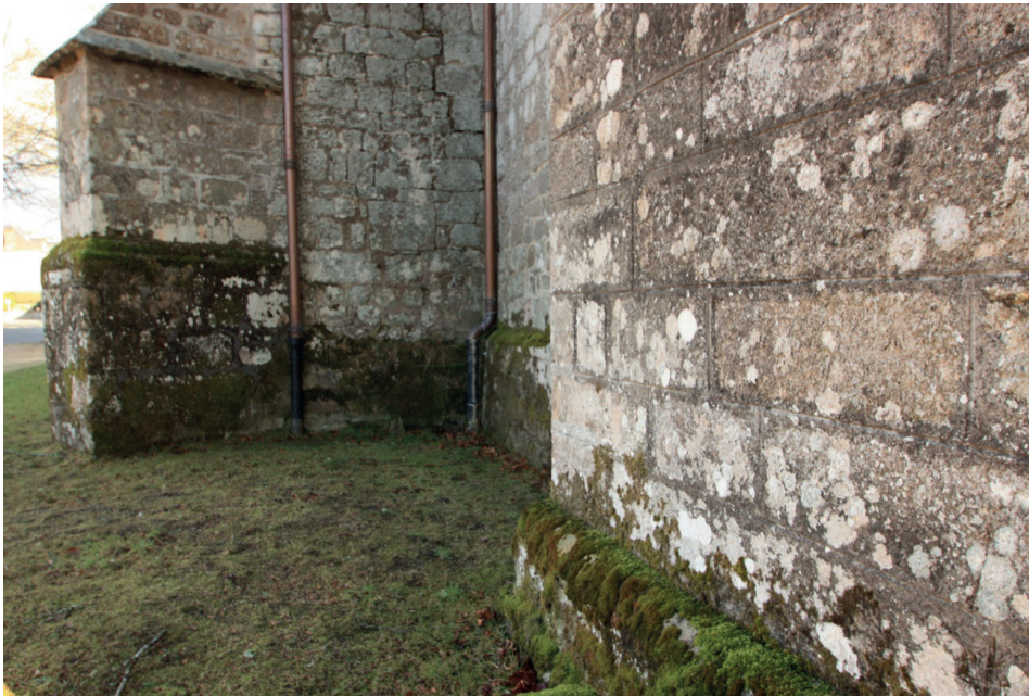
Fig. 5. Église de Sainte Croix (Rosiers-d'Égletons, sud-ouest de France), inspection effectuée par HeritageCare le 26/02/2019.
