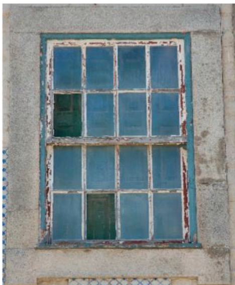
Fig. 7. Estación telegráfica y de tráfico de Cantareira (Oporto, Portugal), inspección realizada por HeritageCare el 20/02/2018: detalle del marco de la ventana.
