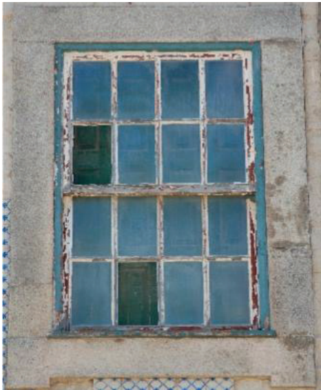
Fig. 7. Estação telegráfica e de tráfego de Cantareira (Porto, Portugal), inspeção efetuada por HeritageCare em 20-02-2018: detalhe da caixilharia de uma das janelas.
