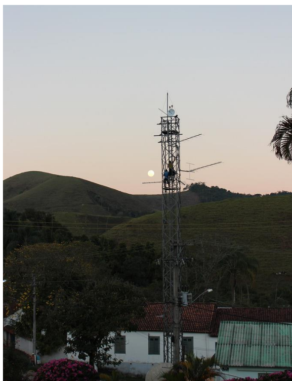
Imagen 13: Instalación de una antena y router en una torre. Resende, Brasil. Abril 2016.
