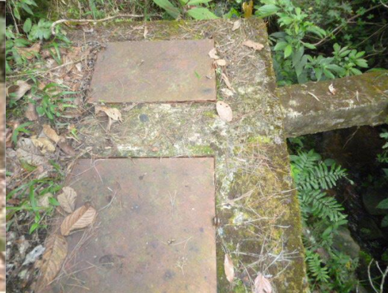
Figura 8. Tanque desarenador Terraplén
