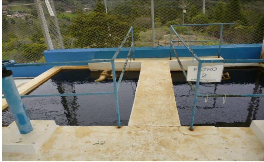
Figura 10. Área de filtración planta de tratamiento convencional
