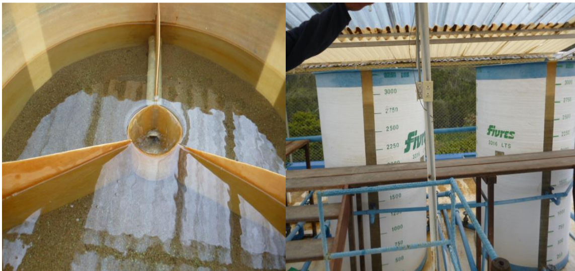
Figura 9. Planta de tratamiento compacta
