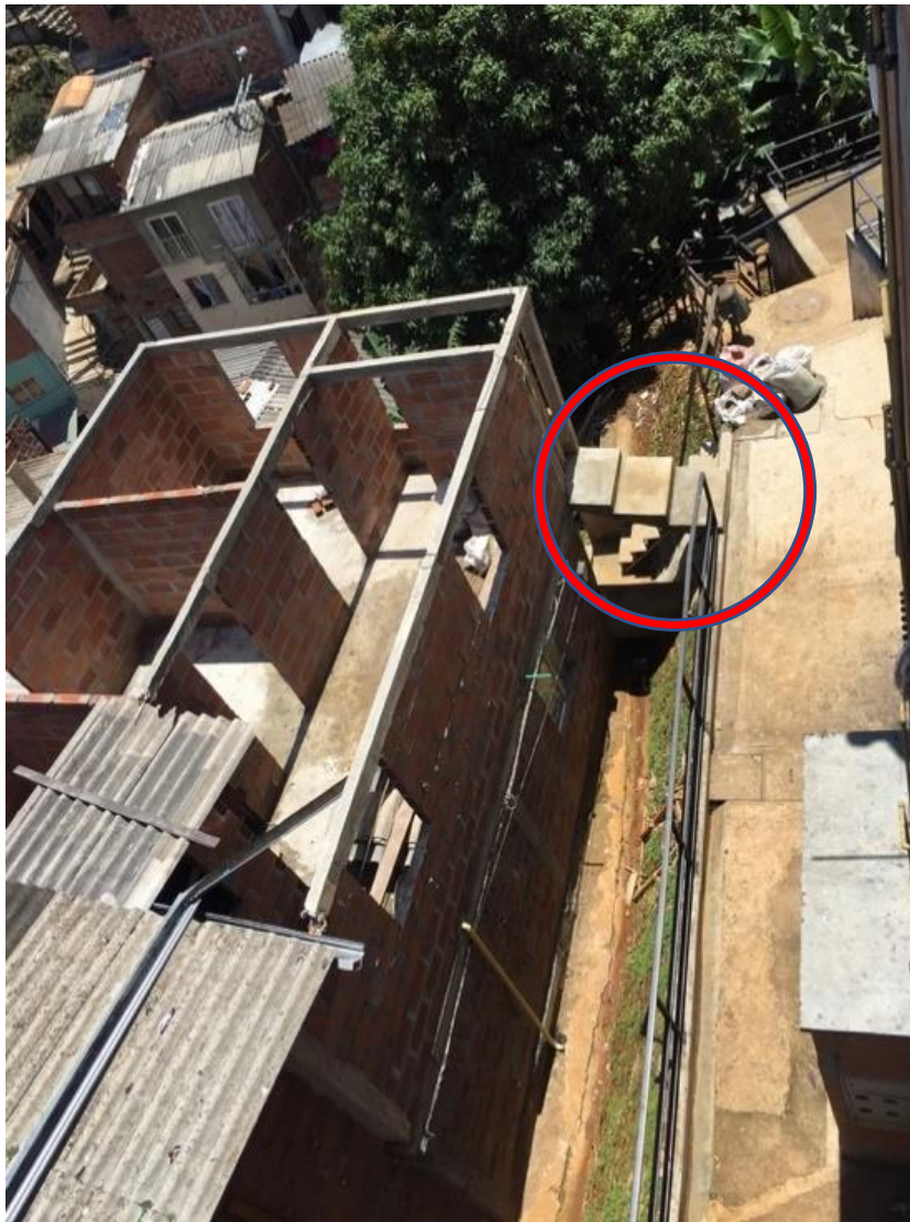
Imagen N°11. Construcción de una casa adherida al costado del Bloque 4 a través de un corredor escalonado. (Fuente: Foto realizada por la autora)
