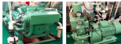
(d) diesel generator (e) pump load
