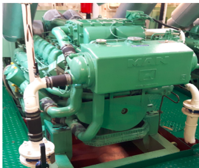
(d) Diesel generator
