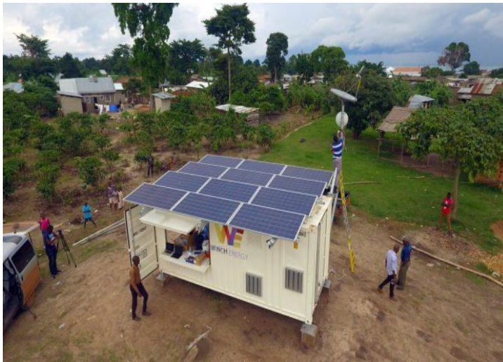
FIGURE 1.1.2: Winch Energy solar kiosk.
